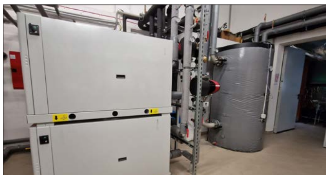
Költségtakarékossági okból megoldotta az önkormányzat a sportcsarnok geotermikus fűtésének kialakítását
