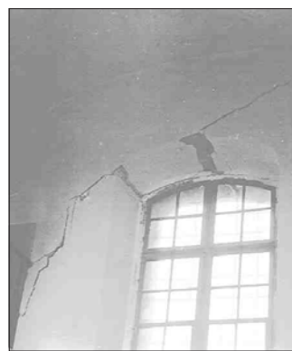
1960-as évek, repedések az északi falon
